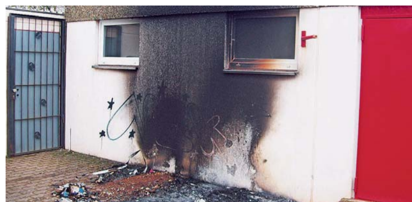
Vier Mülltonnen sind auf der Sportanlage Zewen in der Nacht zum Karfreitag vollständig abgebrannt. Das Feuer hat große Schäden an der Fassade der Umkleidekabine hinterlassen. FOTO: SPVGG ZEWEN
